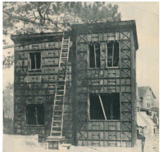
9. Het betonnen huis voor het gieten van het beton ( De Prins der Geïllustreerde Bladen 10 (1911) 13 mei)
