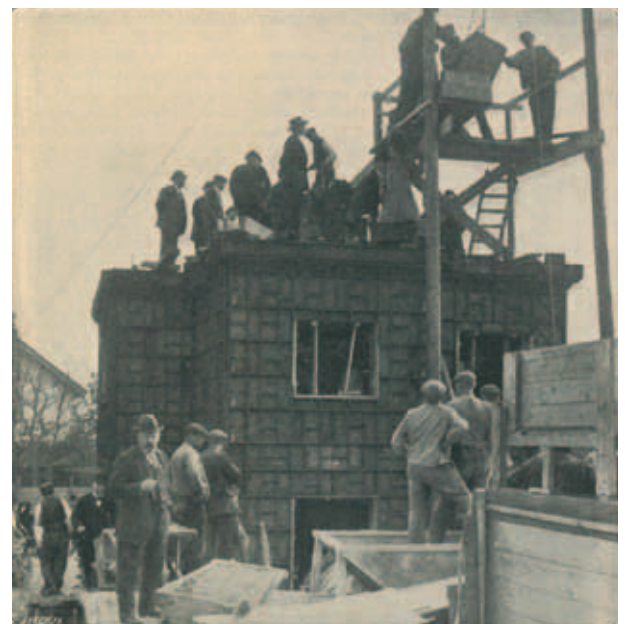
13. Het betonnen huis tijdens het gieten ( De Prins der Geillustreerde Bladen 10 (1911) 13 mei)
