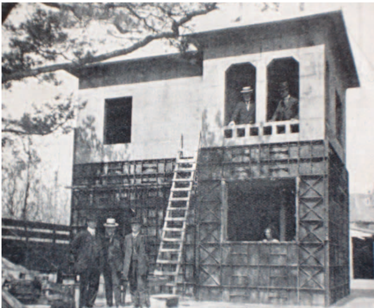
10. Het betonnen huis tijdens de verwijdering van de gietijzeren panelen ( De Prins der Geïllustreerde Bladen 10 (1911) 20 mei)
