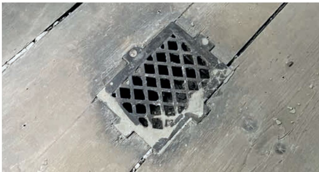
7. Aanvoerrooster voor warme lucht opgenomen in de vloer (foto Matthijs de Kraker, wdjArchitecten)
