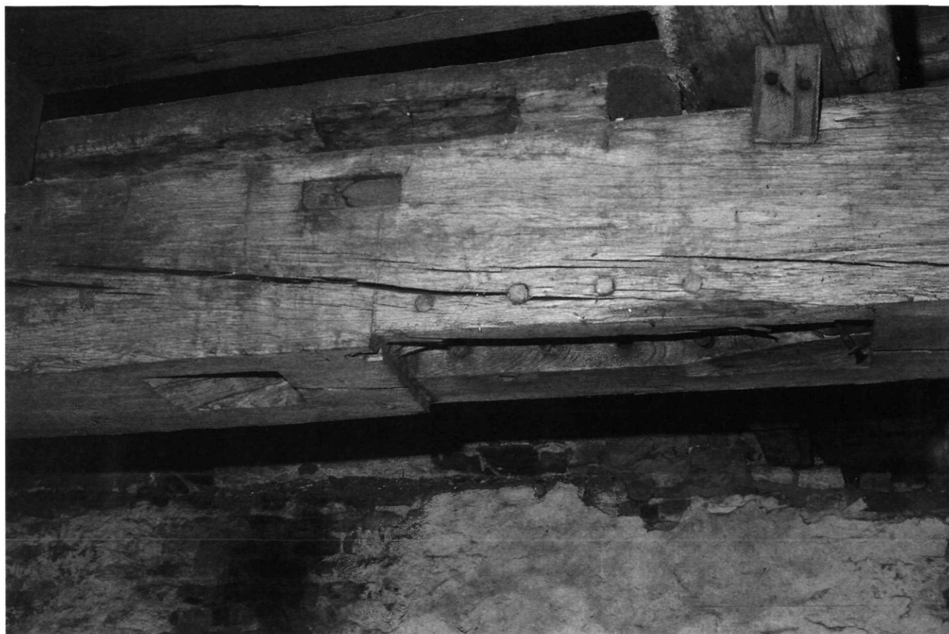
Afb. 7. Detail van de als trek balk hergebruikte hoekstijl. Duidelijk zichtbaar is het grote pengat van het korbeel dat de tussenbalk ondersteunde. Links daarvan een keep met mortelresten waarschijnlijk aangebracht bij de reparatie van 1617. Hierboven de afgezaagde pen van een horizontale regel.
