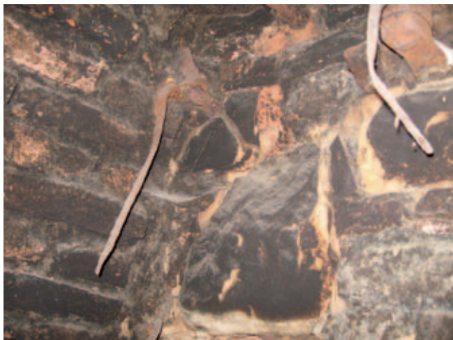
Afb. 6. Twee trekstangen in het rookkanaal, die door corrosie hun functie geheel verloren hebben (foto Rijksdienst voor het Cultureel Erfgoed)
