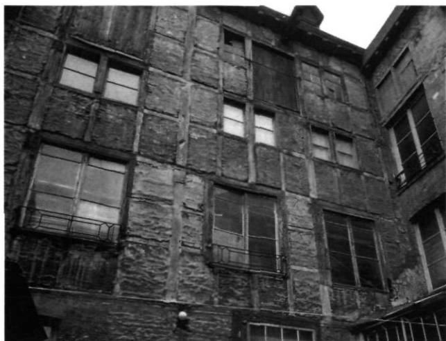
Afb. 14. Muntstraat 31, noordelijke zijgevel van de vakwerk achterbouw met secundaire vensteropeningen en laadluiken (foto: RDMZ 1961)
