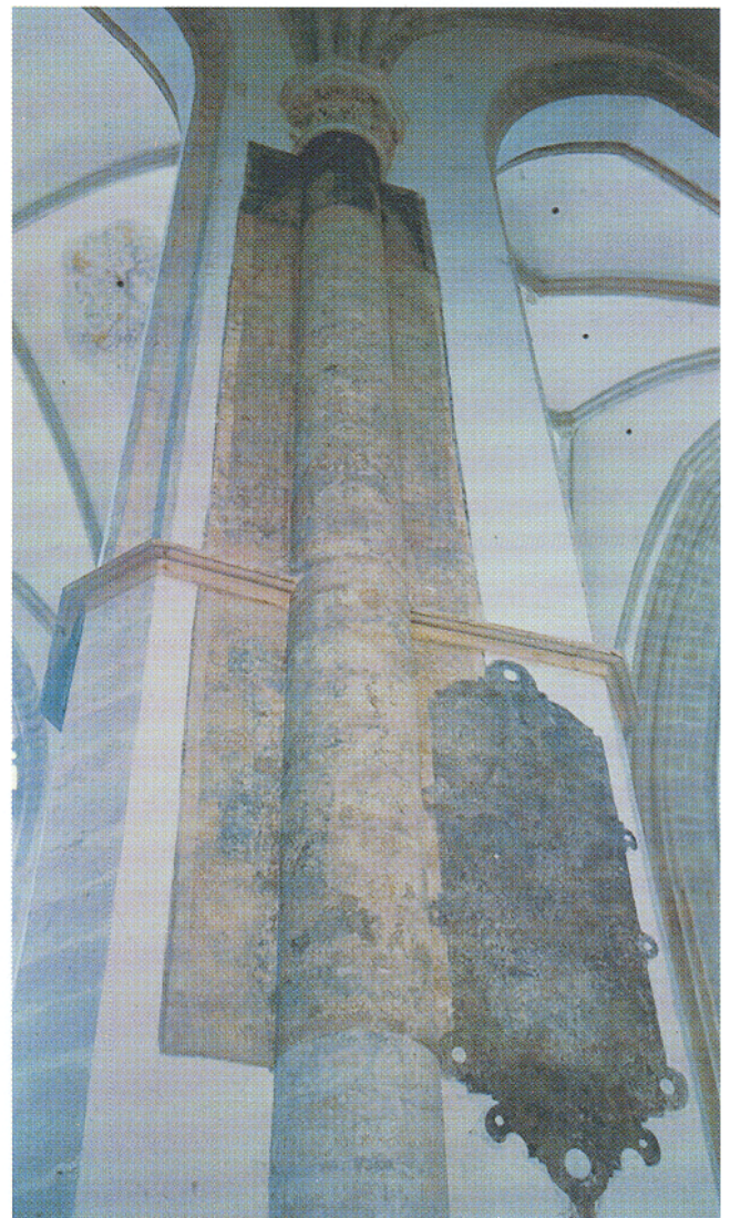
Afb. 2. Eén van de drie kolommen in het koor van de Grote of O.L.V. Kerk te Breda met resten van een brokaat imitatie (foto: SRAL Maastricht, A. Friedrichs 1998).
