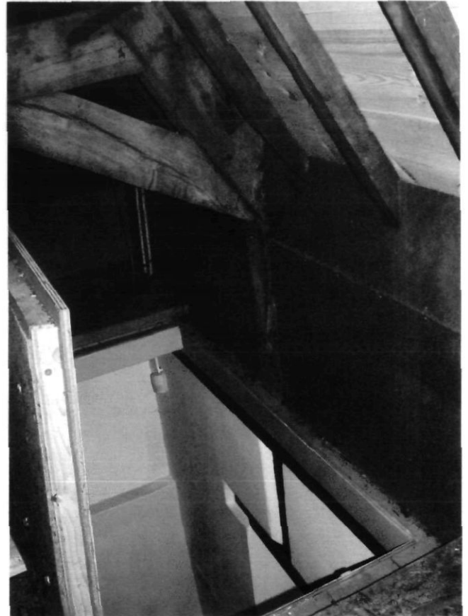
Afb. 7. Onderste gedeelte van het Nijmeegse spant in de woontoren. Bij de verdiepingwijziging is het gedeelte rond de standzoon onder de huidige zoldervloer dichtgezet met metselwerk.
