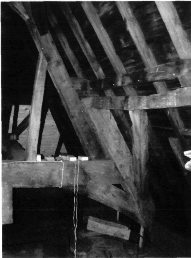
Afb. 6. Detail van de kapconstructie van de woontoren met het zogenaamde Nijmeegse spant in eiken en daarop een 19de-eeuwse constructie in grenen
