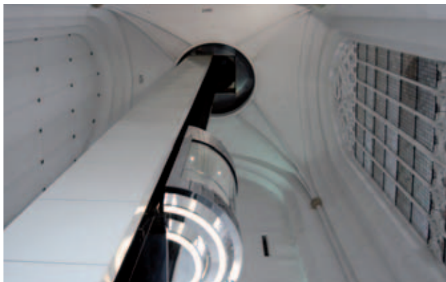
Afb. 6. Arnhem, Eusebiuskerk, deels glazen schacht van de panoramalift voor bezoekers van de torenzalen, door Otis naar ontwerp van AGS architecten (foto auteur)
