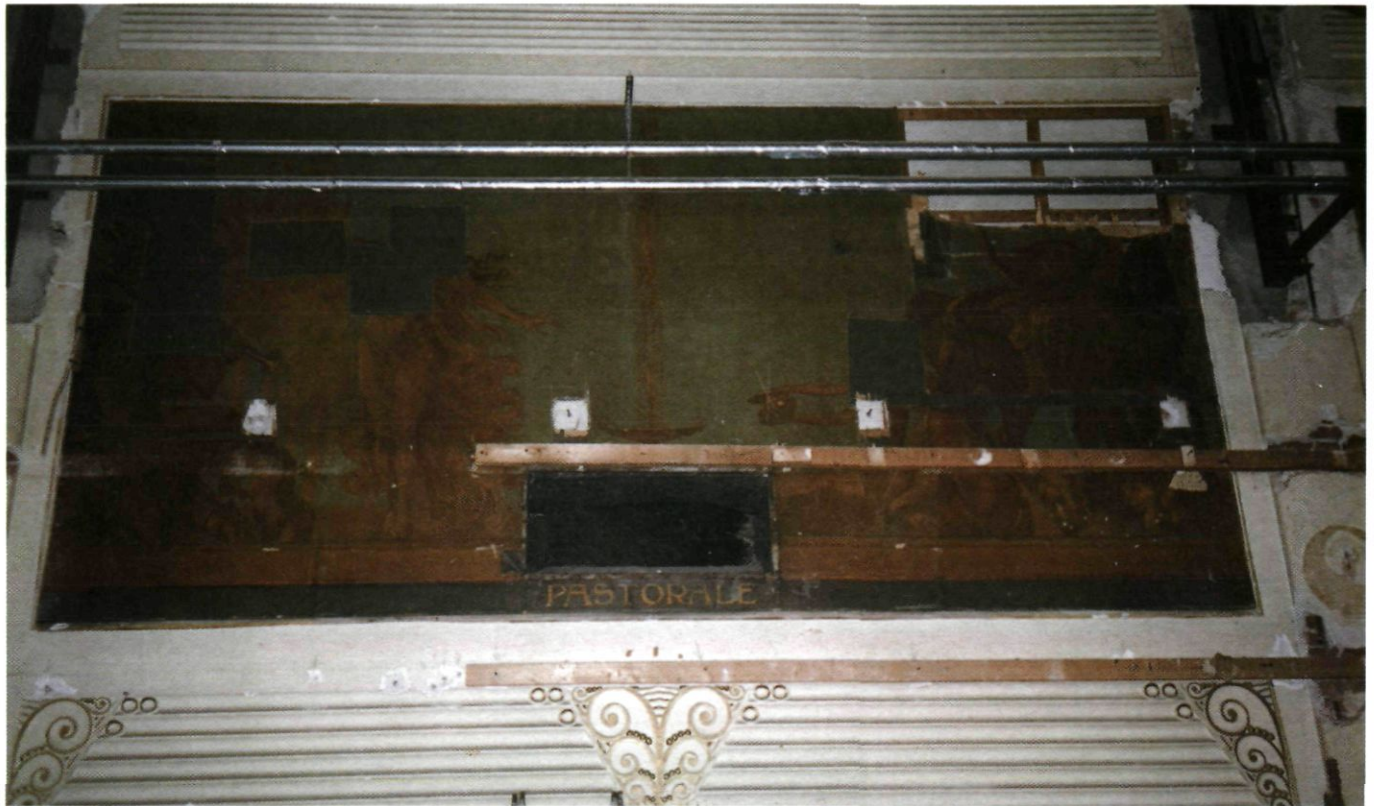
Afb. 7. Wandvlak met 'Pastorale' na gedeeltelijke ontmanteling. Zichtbaar zijn de grote rechthoekige luchtkanaalopening midden beneden in de schildering, gaten voor het aanbrengen van het reeds verwijderde verlaagd plafond, moedwillig aangebrachte beschadigingen ter hoogte van de koppen van de figuren, de weggehakte consoles en uiterst rechts een afdruk van een wandarmatuur van de oorspronkelijke verlichting (foto auteur 1999)
