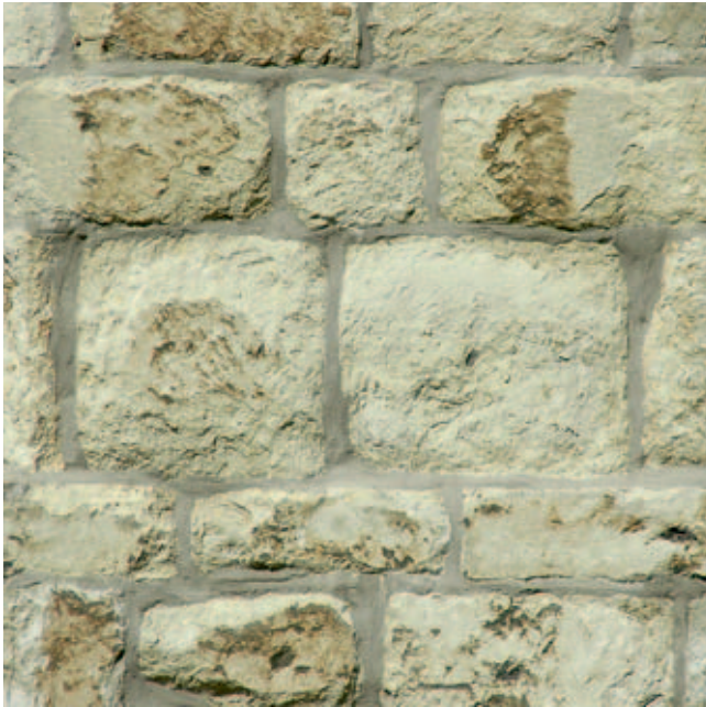
Afb. 10. Metselwerk in Ledeesteen, ontdaan van korsten en opnieuw gevoegd. Steunbeer zuiderzijbeuk (foto september 2009)
