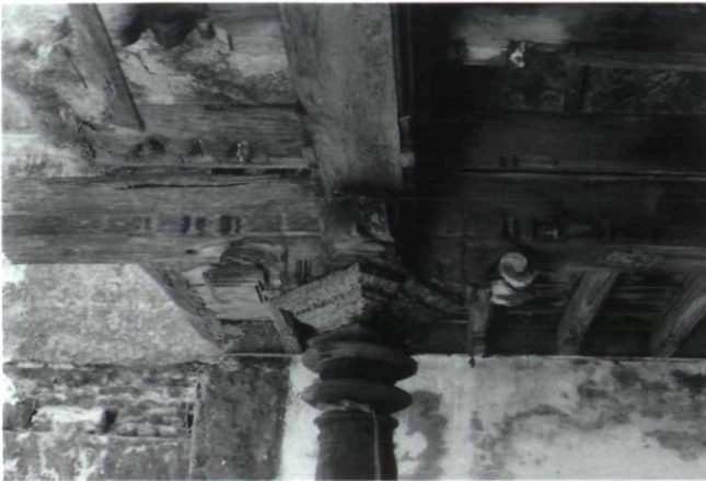
Afb. 17. Houten kolom die de veranda draagt. De detaillering verraaft het vakmanschap van de Indier en de rijkdom van de Hollander (foto Hans Schiebreek)
