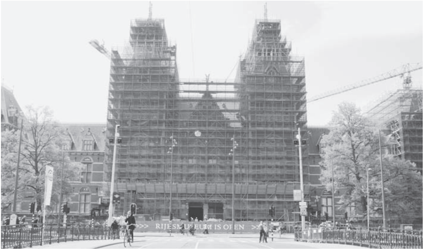
Afb. 3 Amsterdam, bouwplaats van 'Het Nieuwe Rijksmuseum' van architectenbureau Cruz y Ortiz, mei 2010. Architectuurgeschiedenis een plaats geven in geschiedenis, kritiek, debat, ruimtelijk ontwerp en beleid. Een uitdaging voor de architectuurhistoricus? (foto auteur)
