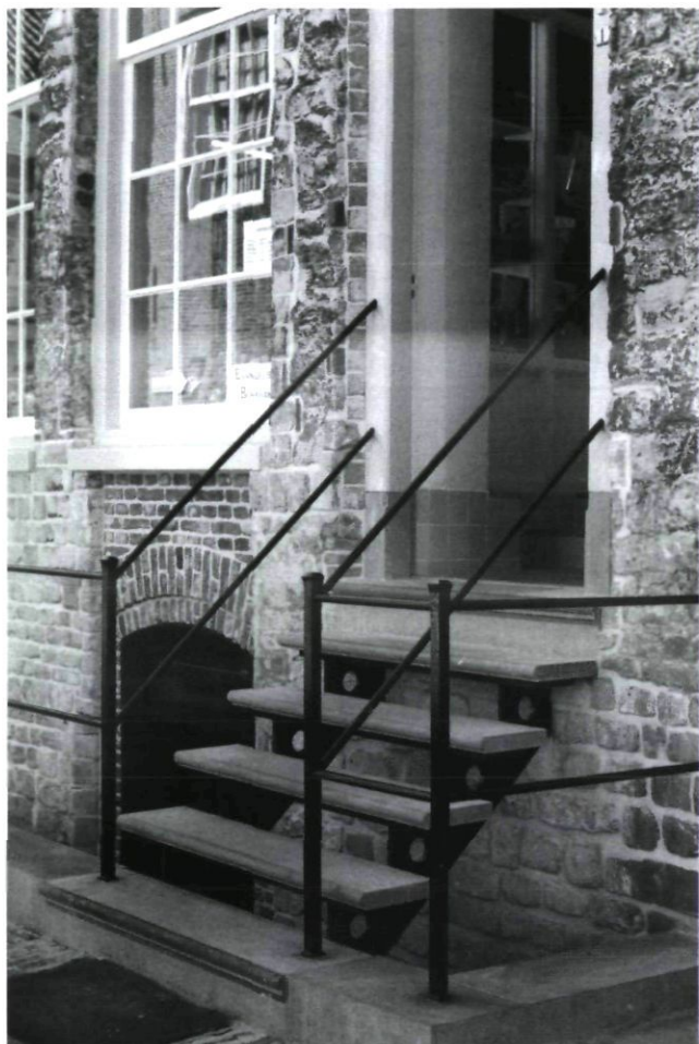
Afb. 11. de keldertoegang en de nieuwe trap naar de voordeur, foto J. Weys.
