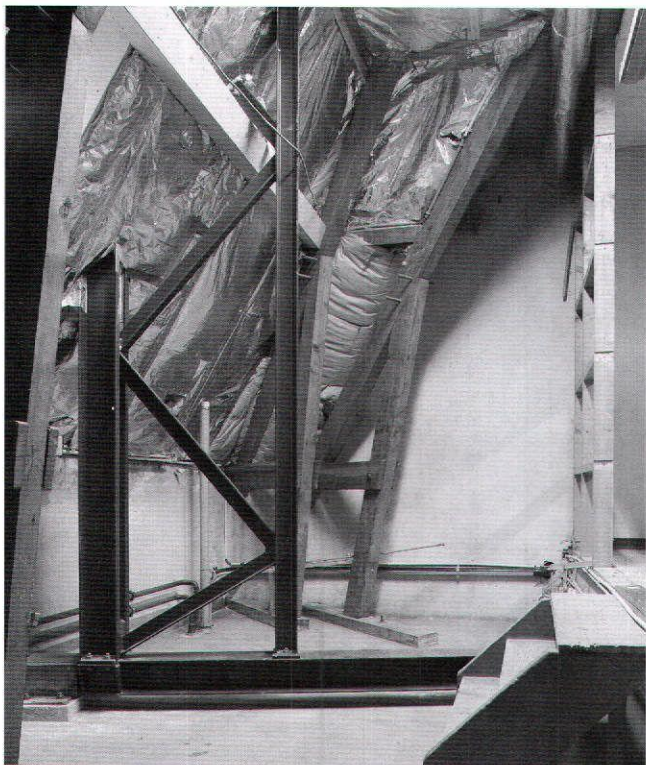
Afb. 14. Groningen, bij het Provinciehuis op zolder. Het dakbeschoot is afgedekt met isolatiemateriaal en de stalen draagconstructie van de overkapping perforereert het dak. Foto: Rijksdienst voor Archeologie, Cultuurlandschap en Monumenten, Chr. Booms, februari 2008
