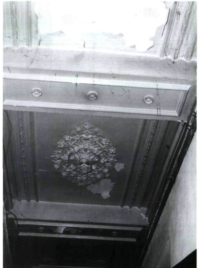
Afb. 9. Stucplafond in de gang, voor restauratie.
