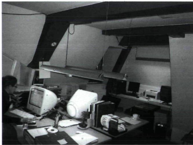
Afb. 13. Kapconstructie op het voorhuis van Jodenbreestraat 4. De spanten dateren waarschijnlijk uit het begin van de 17de eeuw (foto auteur 2006)
