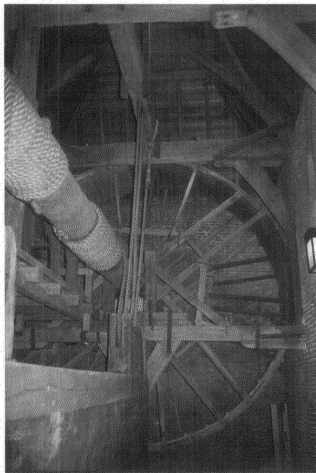
Afb. 1. Inwendige constructie uit 1452 ± 5 met tredrad, korbeelstellen en kap in de Koppelpoort te Amersfoort (foto auteur 1988).
