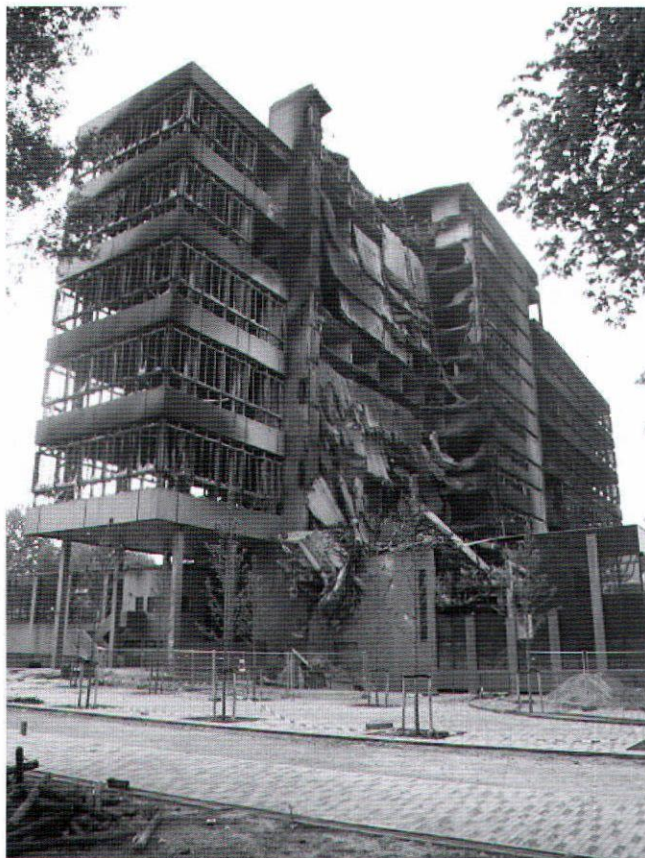
De noordwestelijke zijde van de Faculteit Bouwkunde, TU Delft na de brand van 13.5.2008 (foto Bouw- en Woningtoezicht gemeente Delft)
