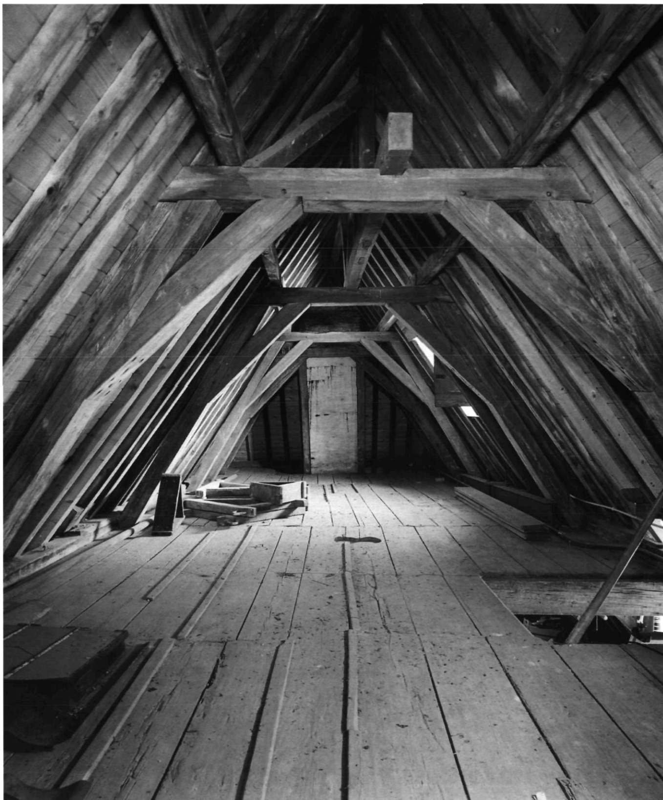
Afb. 8. Deels 17de-eeuwse grenenhouten kapconstructie op de vliering van het voorste gedeelte van het huis. Foto RDMZ, 2003.
