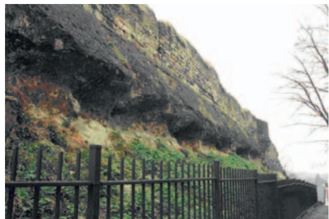
Afb. 2. Ruïne van het kasteel van Valkenburg (12 de -17 de eeuw), met de overblijfselen van de omringende muur in mergel bovenop een wand van dezelfde kalksteen. Verwering van zowel de muur als de wand is duidelijk zichtbaar (2001)
