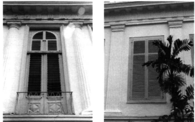
Afb. 7 en 8. De vensters aan de voorzijde van het hoofdgebouw op de piano nobile: een verdiepinghoge kozijn geflankeerd door halfzuilen op het risaliet (links) en een rechthoekig venster geflankeerd door pilasters ter zijde van het risaliet (rechts) (Opname M.J. van Reenen, november 2004)
