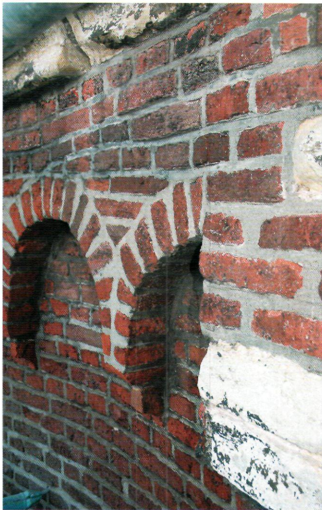
Afb. 6. Foto van horizontale correctie vanwege verzakking tijdens de bouw (BMA, Gabri van Tussenbroek)
