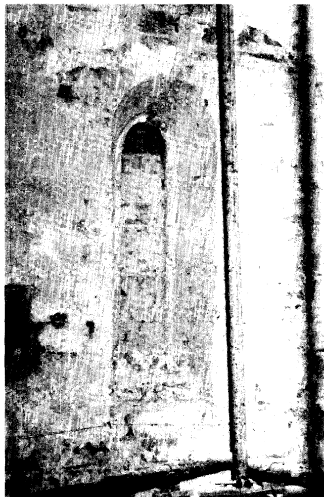
Afb. 20. Het gedichte oorspronkelijke koorvenster in de noordzijde van de sluiting (foto F. Haans 1998)
