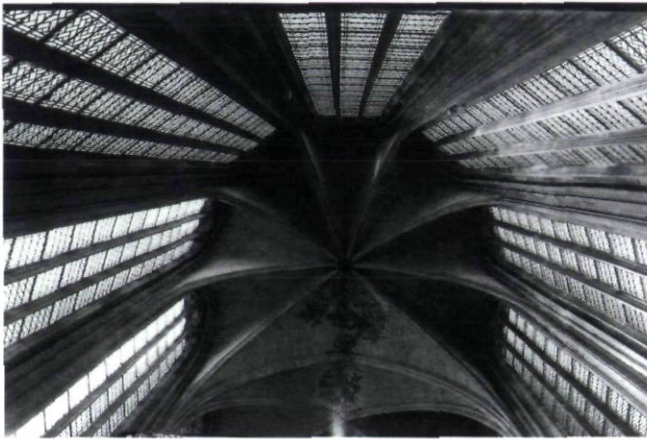
Afb. 27. Minderbroederskerk, voormalige kerk van de franciscanen in Maastricht: gewelf van de apsis (foto: THOC, maart 2001).
