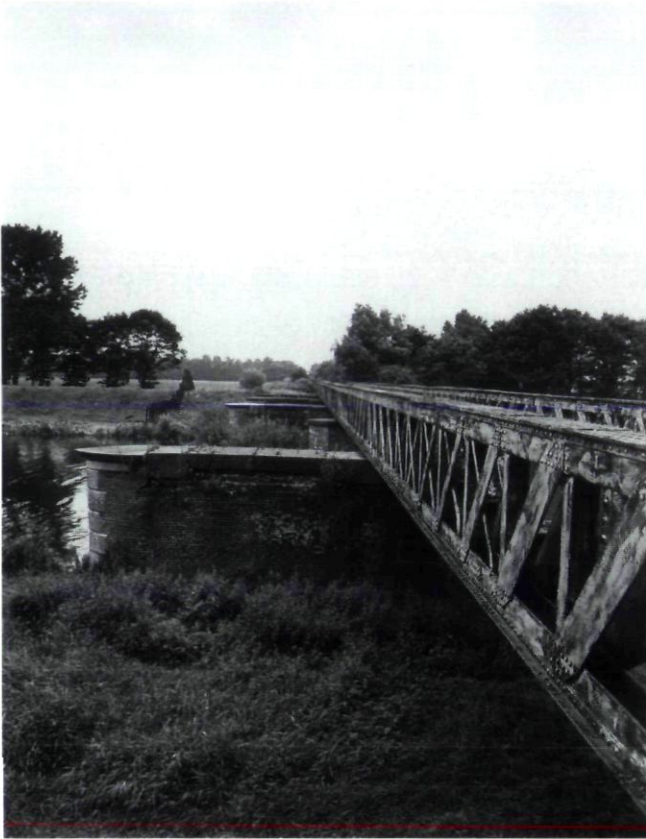
Afb. 5. Waalwijk, voormalige spoorbrug over het Afwateringskanaal 's-Hertogenbosch - Drongelen, gezien naar het oosten. Foto L. Tangel, RDMZ, augustus 1988.
