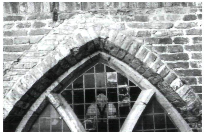
Afb. 16. Wijziging van een vensterkop in de koorluiting ten behoeve van het aanbrengen van de nieuwe tufstenen traceringen in de vroege 20ste eeuw.
