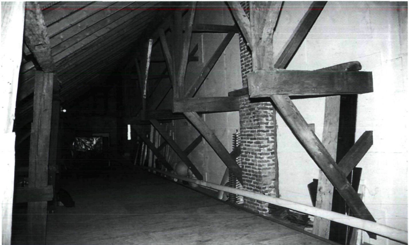
Afb. 15. Maastricht, St. Servaas, noordelijke pandhof, zolder: nokdragende vakwerkwand op uitkraging uit ca. 1495 (foto D.J. de Vries 2003)
