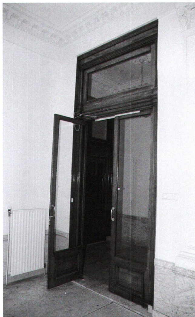
Afb. 9. 'Maaslust', de pui (uit 1900) tussen portaal en gang, gezien vanuit de gang. Merk op dat beide ruimten eenzelfde stucplafond (uit 1874) hebben (foto auteur)
