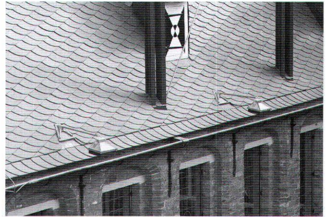
Afb. 13. Groningen, detail van het gloednieuwe leien dak van het Provinciehuis met de stalen draagconstructie van de overkapping. Foto: Rijksdienst voor Archeologie, Cultuurlandschap en Monumenten, Chr. Booms, februari 2008
