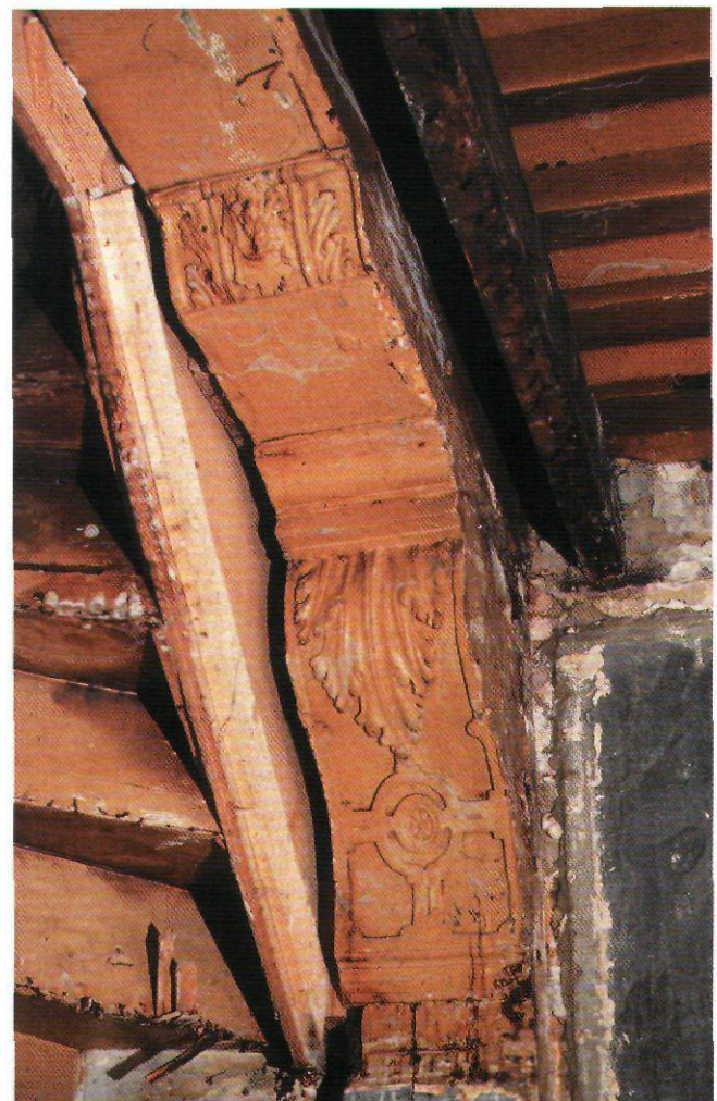
Afb. 17. Oudezijds Voorburgwal 105, Amsterdam. Een van de zwanenhalskorbelen op de eerste verdieping, XVIIe d. Het korbeel bleef aan de rechter zijde onafgewerkt omdat hier oorspronkelijk een wand was gesitueerd (foto BMA)
