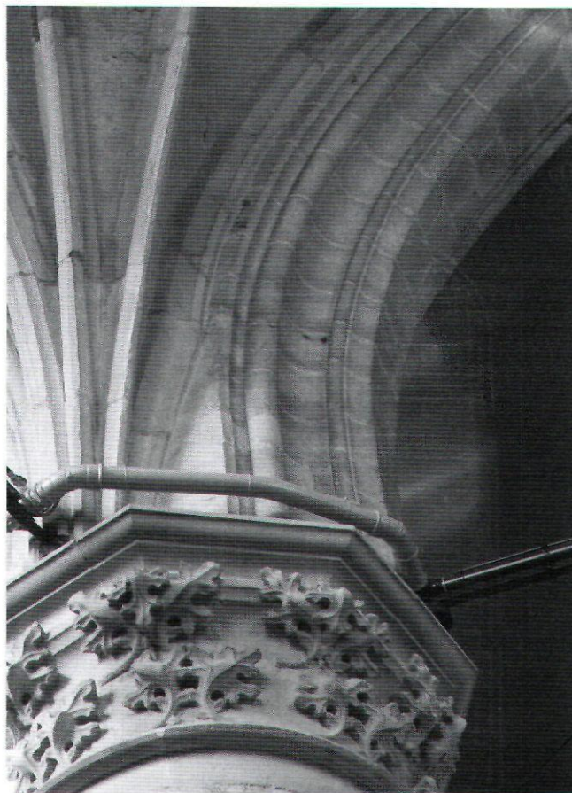
Afb. 6. Alkmaar, Sint-Laurenskerk, knik in de aanzet van het gewelf in de kooromgang, Anthonis I Keldermans/Maerten Gheertsz., 1497 (foto auteur)
