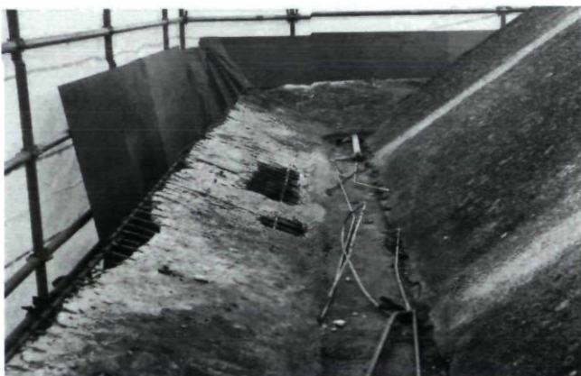
Afb. 14. Maastricht, seinhuis Post T, restauratie van het dak. De wapening van het beton ligt bloot. (Nederlandse Spoorwegen zomer 2003)
