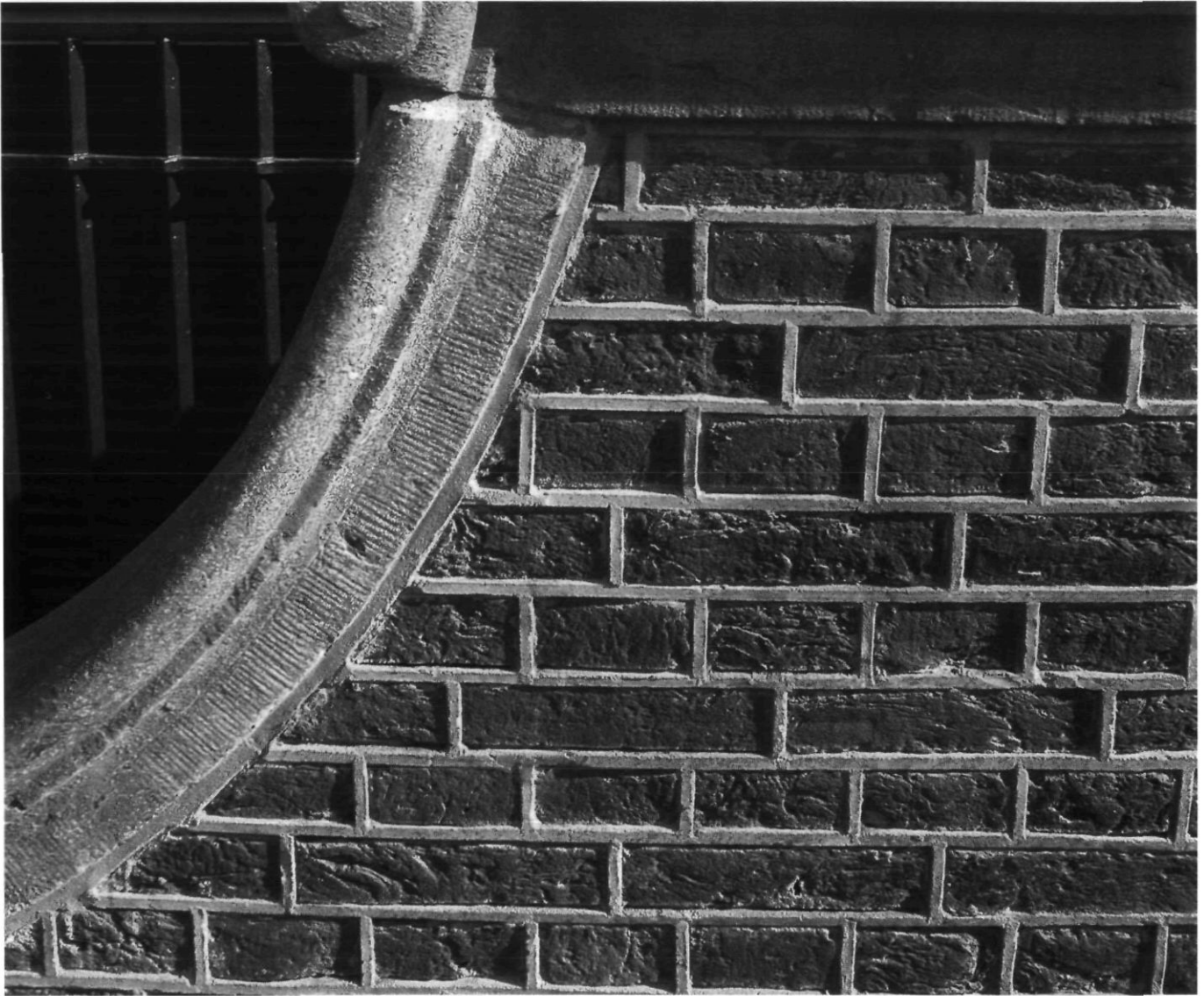
Afb. 17. Amsterdam Keizersgracht 127, vet voegwerk in buitentrap en voorgevel
