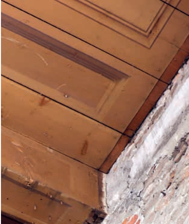
13. Haarlem, Zijlstraat 62-64, plafond Groot Salet, detail van de balkkeinden. De randafwerking ontbreekt, waardoor de geelbruine ondergrond van de schilderingen duidelijk zichtbaar wordt. Ook is op deze foto duidelijk de schaduwwerking bij de panelen zichtbaar (foto Team Erfgoed Haarlem)
