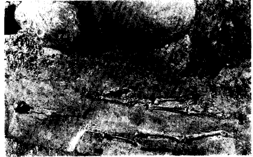
Afb. 6. Zwerfkeien fundering onder het koor van het tufstenen parochiekerkje. Op hun beurt rusten deze keien weer op oudere bijzettingen.
