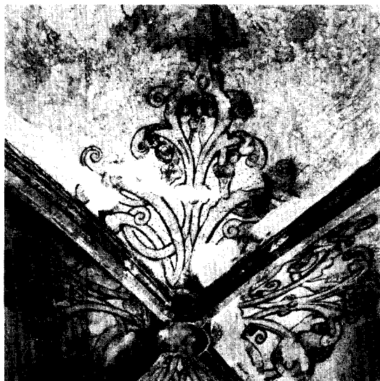
Afb. 2. Gewelfvak met boorgaatjes op de kruispunten van de barsten voor de injectie van het loszittende schilder- en pleisterwerk. (Foto Monumentenzorg 1973).
