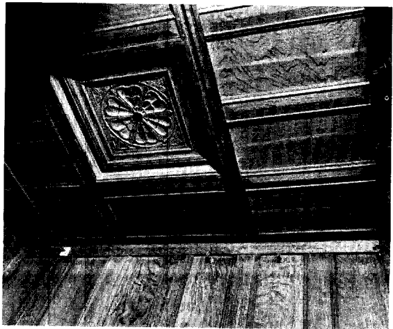
Afb. 4. Ventilatieluikje in de zoldering van de bed- stede, midden 17de eeuw. (Foto Monumentenzorg, 1972)
