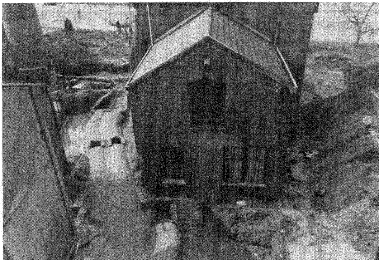
Afb. 5. Mommerscomplex, Tilburg. Van links naar rechts onder: schoorsteen (1920), dubbel rookkanaal (1920), hulp-rookkanaal (1920), schoorsteenfundering (1889) onder kantoorgebouw (foto J. J. Briefjes).
