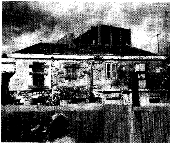
Afb. 13. Dichtgespijkerd woonhuis op Pietermaai, (Willemstad, Curaçao) in afwachting van sloop of herstel? Op de achtergrond een vorm van minder gewenste schaalvergroting (foto C. L. Temminck Groll, 1986).
