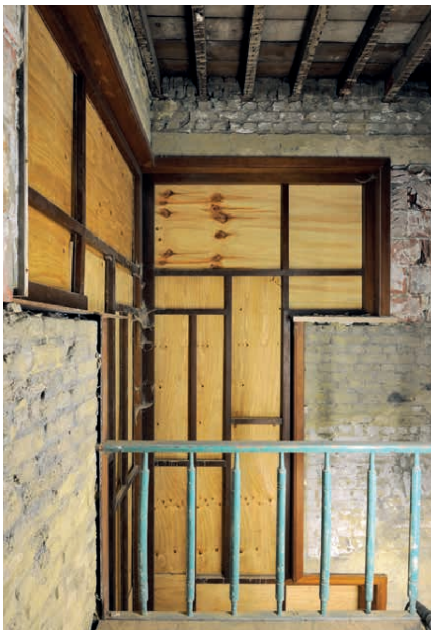
19. Het centrale winkelpand in La Cité Moderne is, in tegenstelling tot wat soms verondersteld wordt, niet uitgevoerd met het Non Plus-systeem, zo bleek uit de restauratiewerken van het pand die werden uitgevoerd door Origin Architecture & Engineering (foto Georges De Kinder). Zie ook pagina 22-23 ►
