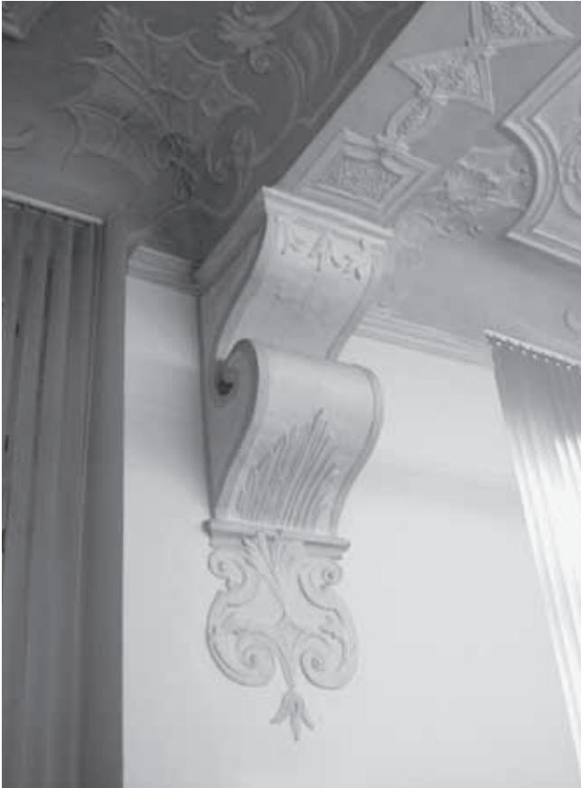
Afb. 3. Gestucte console onder één van de moerbalken in de refter van de Roermondse kartuis (foto auteur 2007)
