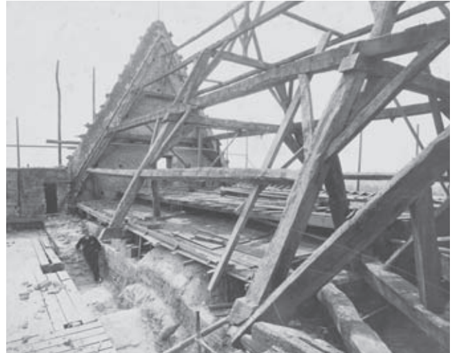
Afb. 5. Toestand van de kap boven het zuidtransept na ontmanteling. Het muurwerk is sterk afgebrokkeld en de kapvoet door houtrot grotendeels verdwenen (foto RDMZ omstreeks 1905)
